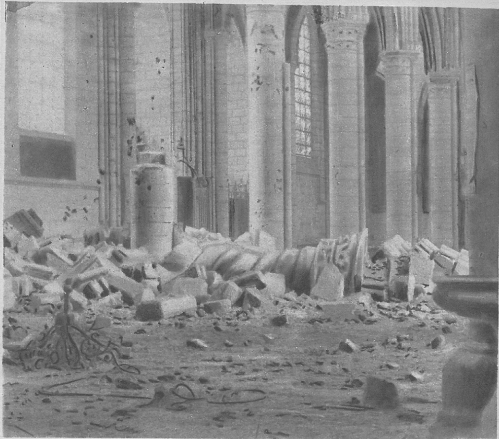
UN DES GROS PILIERS DU TRANSEPT S'EST COMPLÈTEMENT ÉCROULÉ
